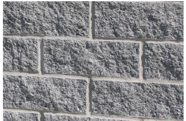
Bild 38: Läuferband mit Lager- und Stossfugen
