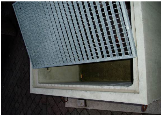
Bild 38: Gitterrost auf Falz (S. Position 13)
