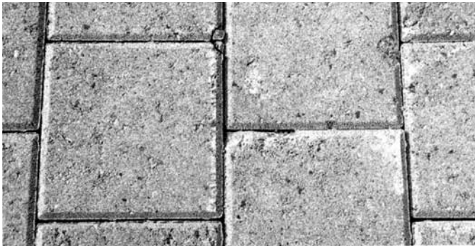
Beispiel von Kantenabplatzungen infolge fehlenden Fugenmaterials
