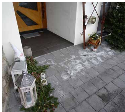
Efflorescences de calcaire sur des pavés en béton récents dans une entrée.
