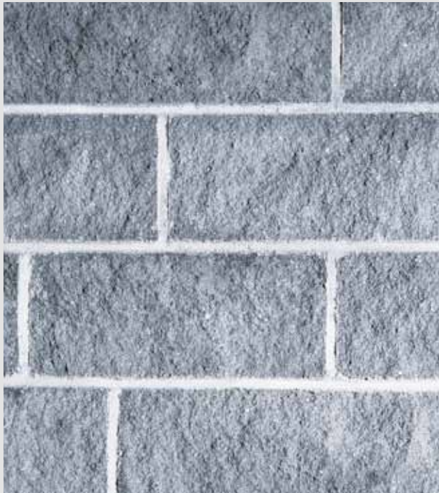
Mörtelfuge aus Trasszement («normaler Zement» blüht aus)
