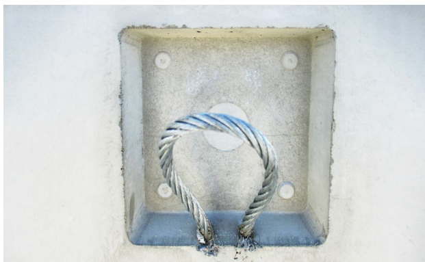
Bild 18: Werkseitig eingebaute Seilschlaufen
