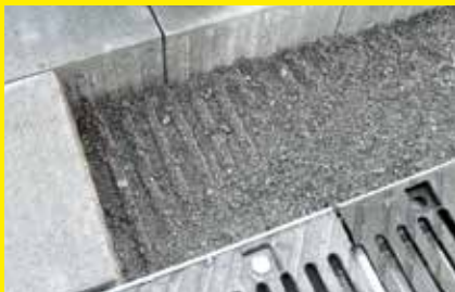
Verkrallung im Pflasterbett
