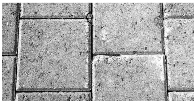
Beispiel von Kantenabplatzungen infolge fehlenden Fugenmaterials
