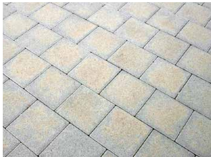
Pflasterstein mit gelb-braun-Verfärbungen
