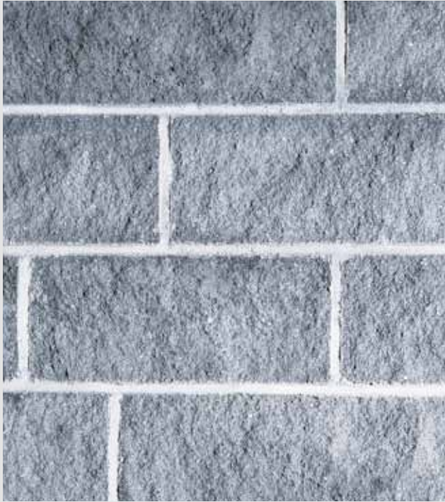
Mörtelfuge aus Trasszement («normaler Zement» blüht aus)
