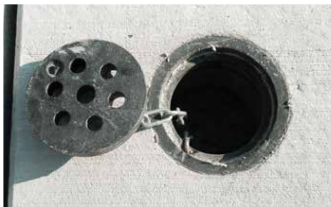
Belüftungs- und Bewässerungsstutzen
