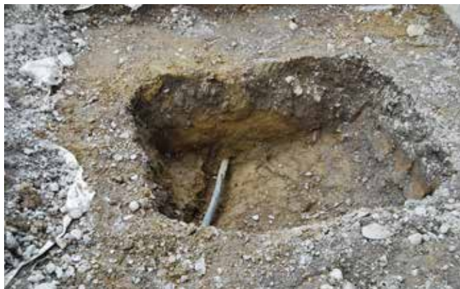
Werkleitungen stören das Wachstum der Baumwurzel
