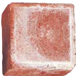
Pflasterstein mit starken Ausblühungen
