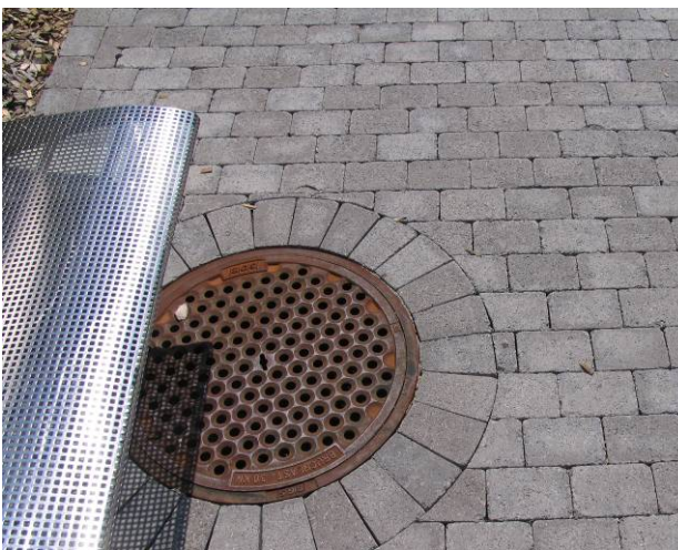
Bild 42: Anpassung bei Schachtabdeckung
