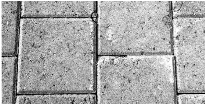
Beispiel von Kantenabplatzungen infolge fehlenden Fugenmaterials
