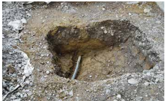
Werkleitungen stören das Wachstum der Baumwurzel
