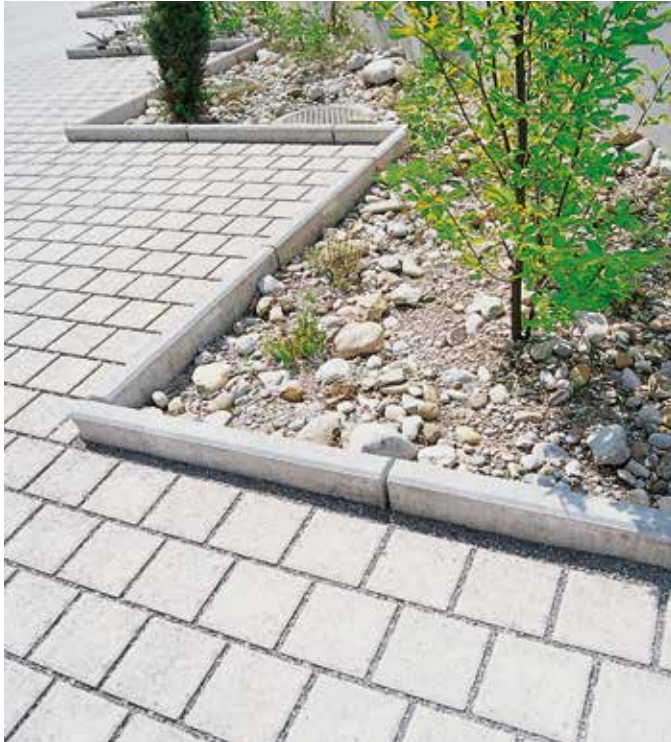
Randabschluss mit offenen Fugen
