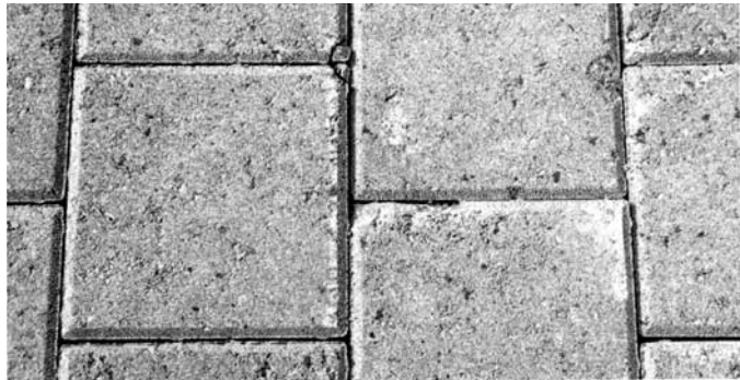
Beispiel von Kantenabplatzungen infolge fehlenden Fugenmaterials
