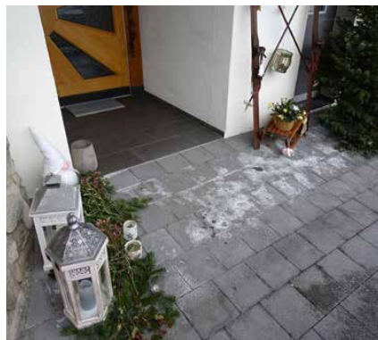
Efflorescences de calcaire sur des pavés en béton récents dans une entrée.
