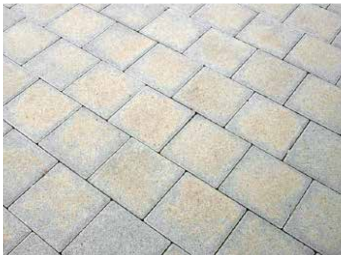
Pflasterstein mit gelb-braun-Verfärbungen
