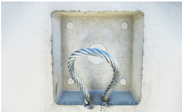
Bild 18: Werkseitig eingebaute Seilschlaufen
