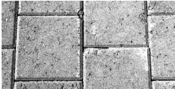
Beispiel von Kantenabplatzungen infolge fehlenden Fugenmaterials
