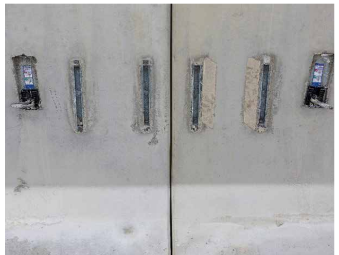
Halfenschiennen als Verbindungsgrundlage
