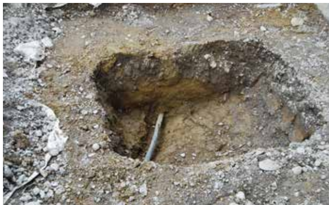
Werkleitungen stören das Wachstum der Baumwurzel
