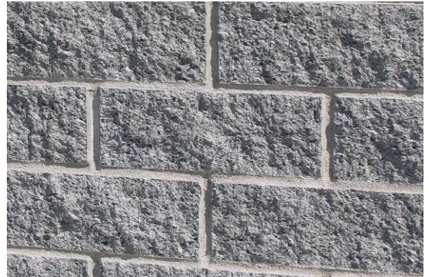
Bild 38: Läuferband mit Lager- und Stossfugen
