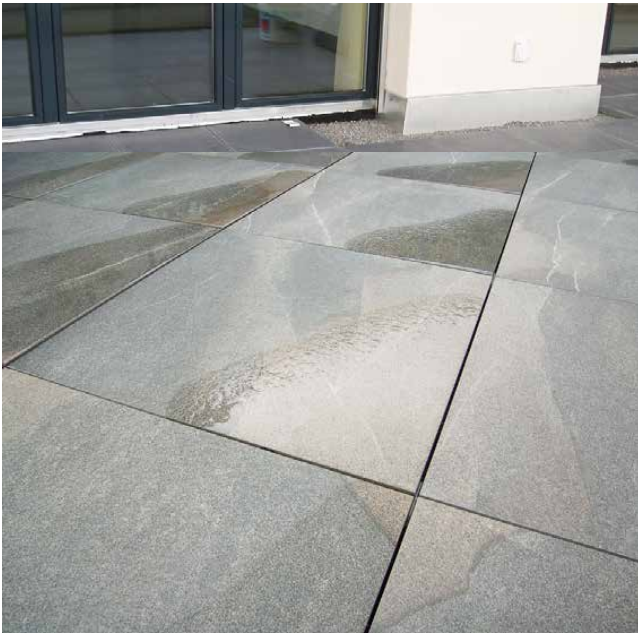
Bild 5: Wasser in Ecken infolge Oberflächenspannung
