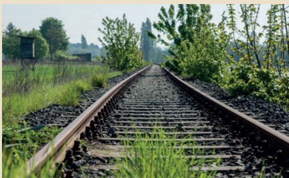
Bahngleis mit Bewuchs
