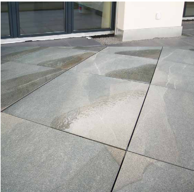
Bild 5: Wasser in Ecken infolge Oberflächenspannung
