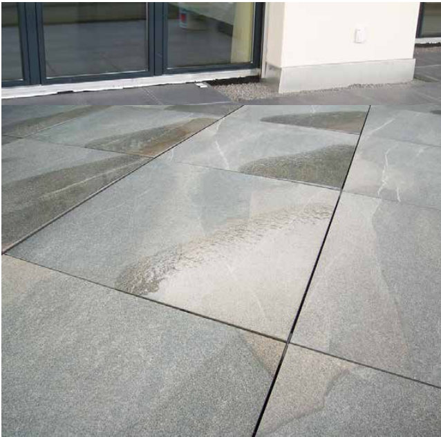
Bild 5: Wasser in Ecken infolge Oberflächenspannung
