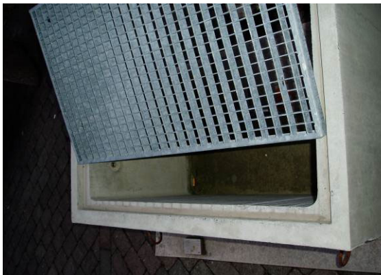
Bild 38: Gitterrost auf Falz (S. Position 13)
