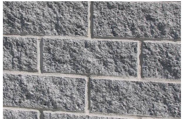
Bild 38: Läuferband mit Lager- und Stossfugen
