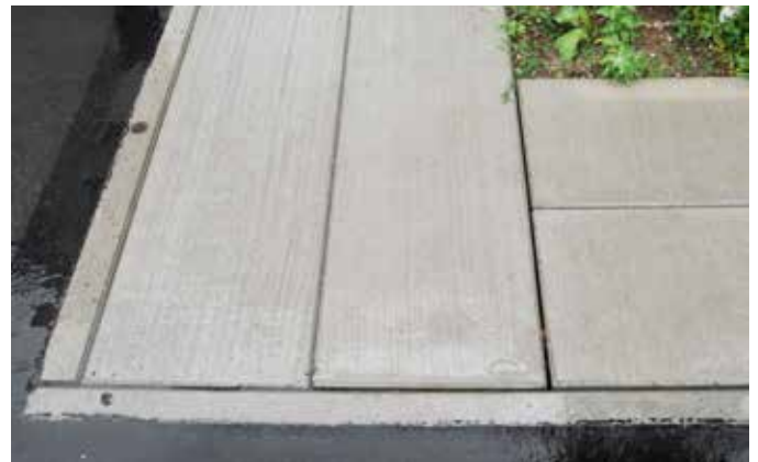
Wasserzufuhr durch Fugen
