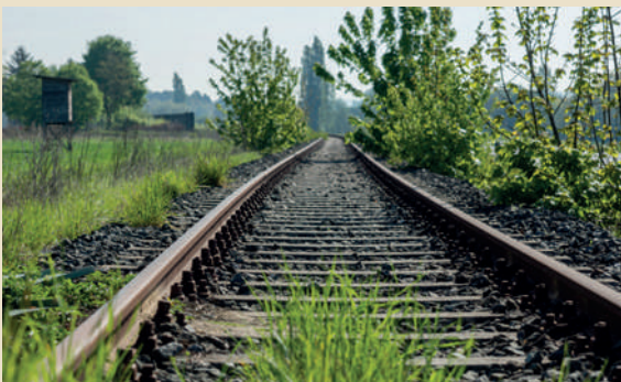
Bahngleis mit Bewuchs
