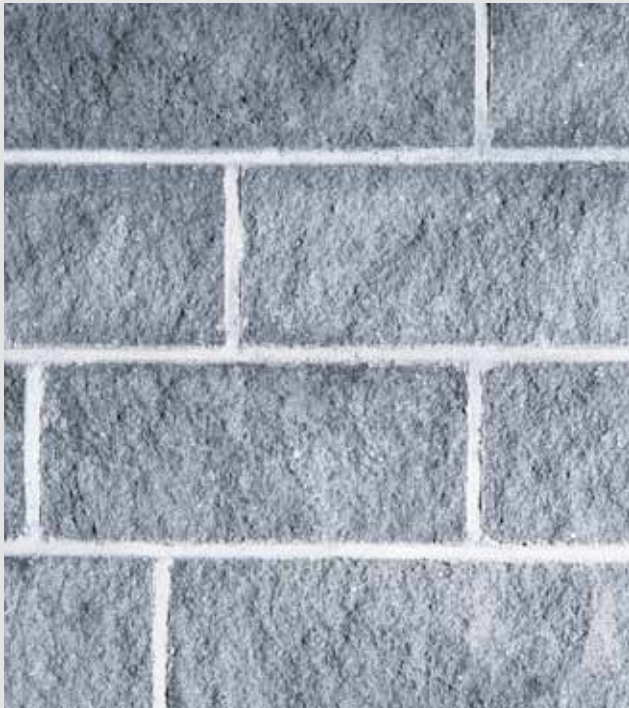
Mörtelfuge aus Trasszement («normaler Zement» blüht aus)
