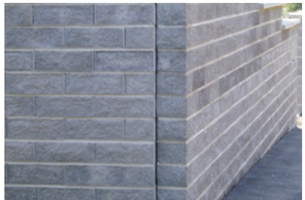
Bild 56: Vertikale Dilatationsfuge bei einer Eckausbildung
